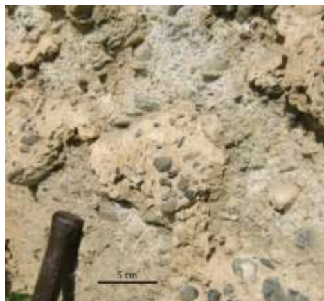
Fig. CH2. Oxydation superficielle et desquamation.
